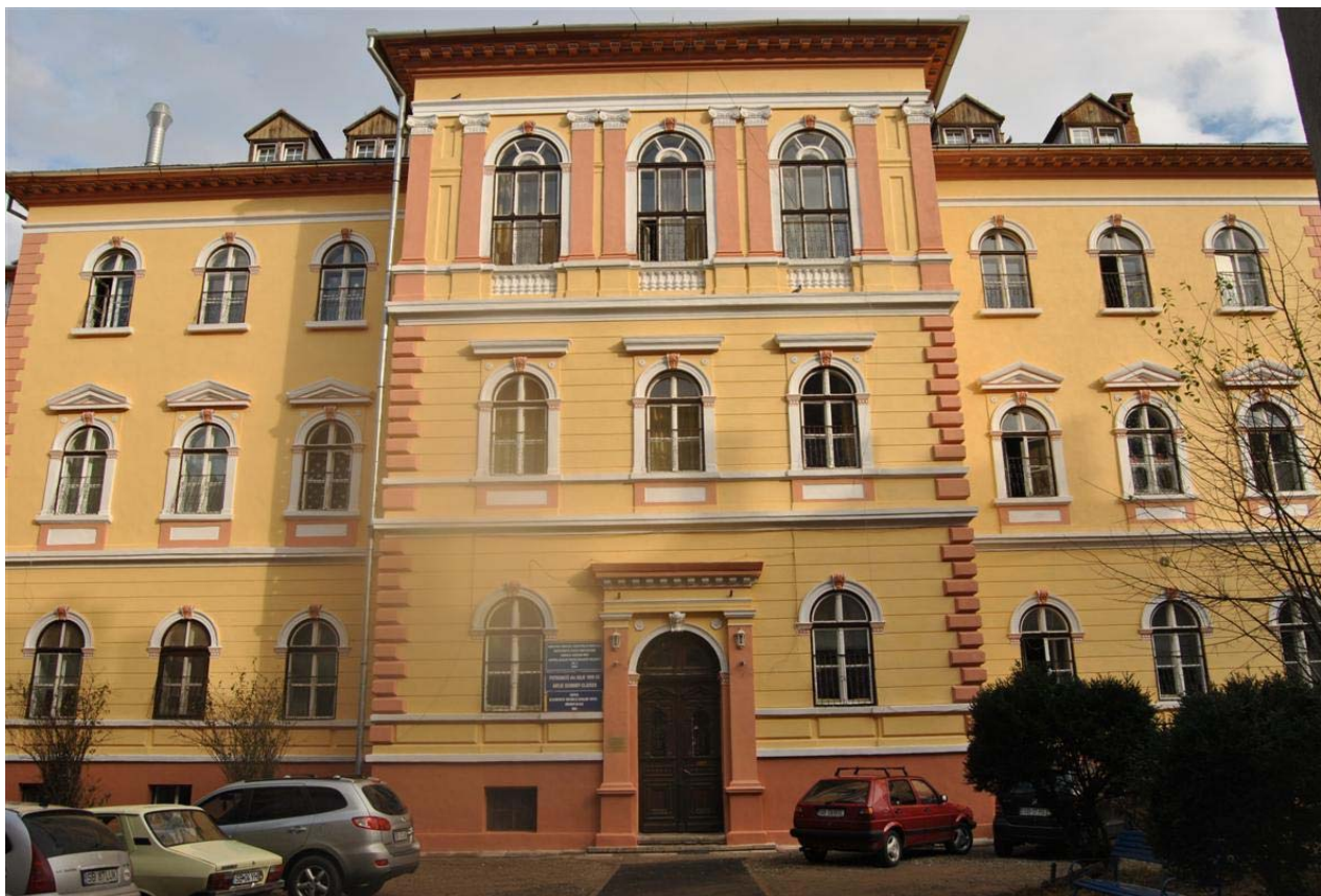
Lucrări de reabilitare exterioară a clădirii în vara-toamna anului 2010. (fațada dinspre strada Andrei Șaguna)
