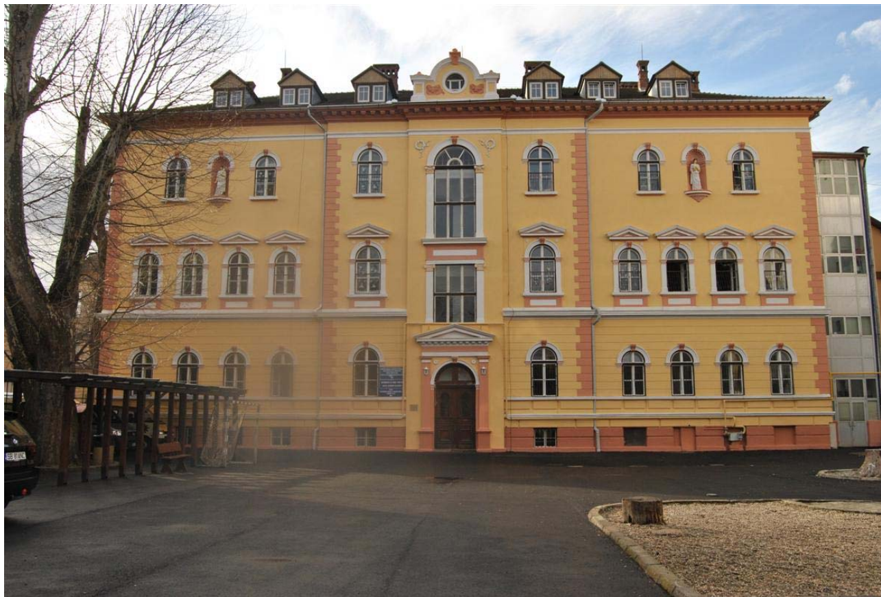
Lucrări de reabilitare exterioară a clădirii în vara-toamna anului 2010. (fațada dinspre parc)
