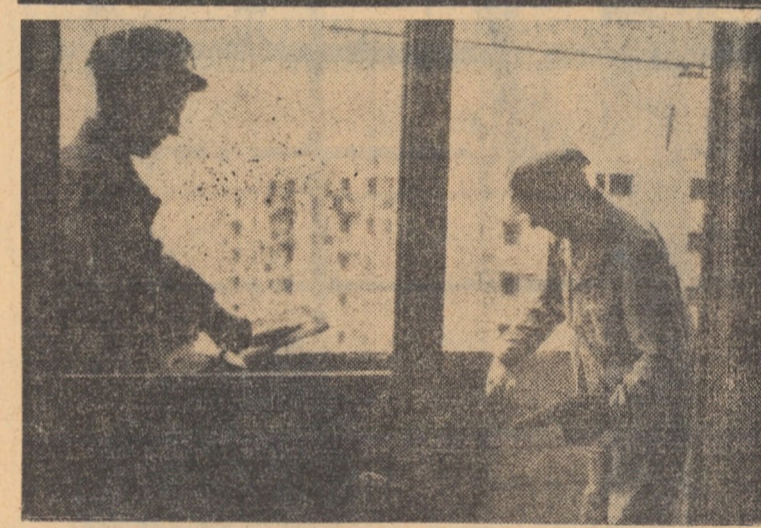
În șantierul Hipodrom Sibiu, echipa de zidari, condusă de Ion Huber, execută tencuiala interioară la blocul nr. 19.
