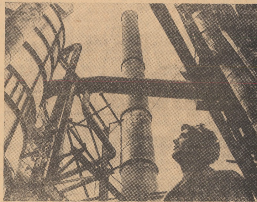
Preincalzitorul de aer al instalațiilor furnal
