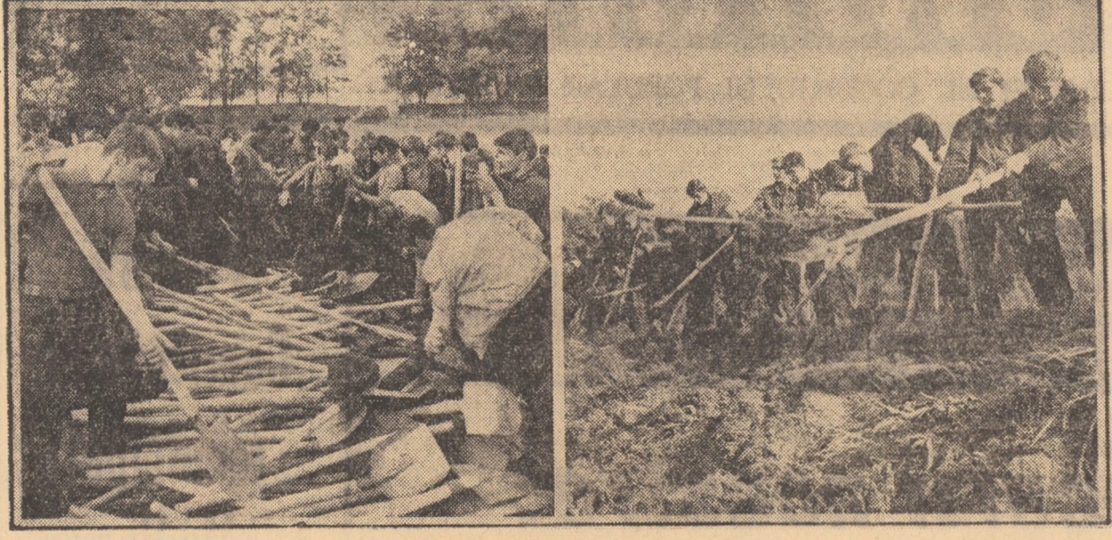
Impărțirea uneltelor (stinga) și în plin lucru (dreapta) — două imagini cotidiene de pe șantierul de muncă patriotică al tineretului „Valea aurie” Sibiu, unde, zi de zi, se întrec elevii mai multor școli, lucrând la amenajarea unui irmos complex sportiv
