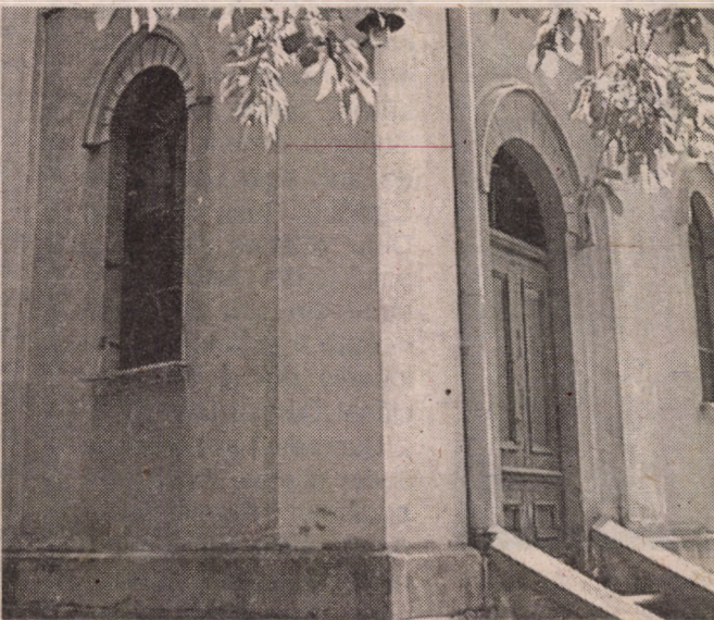
Fereastră din spatele lăcașului, pe unde au pătruns cei trei minori și ușa laterală, pe unde aceștia au scos obiectele furate, demontând rama cu geam și tăind plasa de sârmă.
