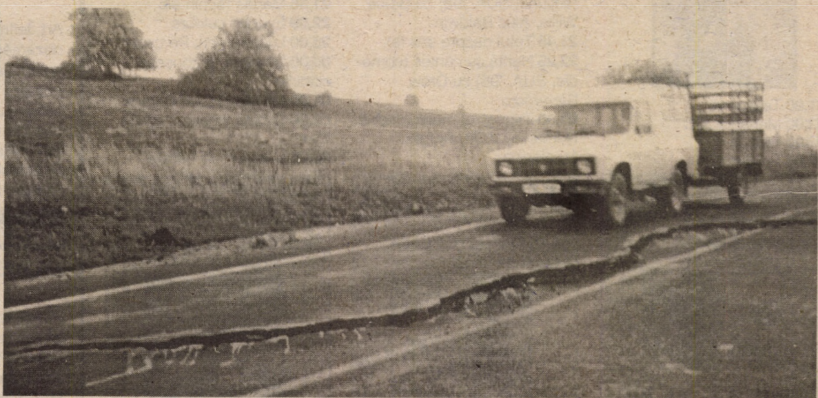
Așa arăta o porțiune de drum județean, înainte de reabilitare
