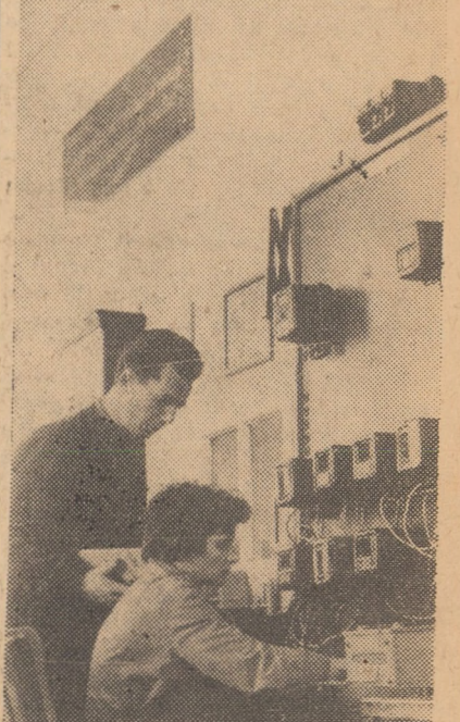
Panou pentru verificarea și etalonarea contoarelor electrice mono-fazice de la I.E. Sibiu
