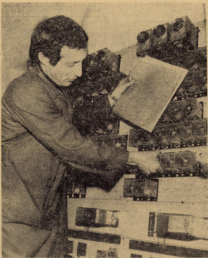
Printre numeroasele realizări ale harnicului colectiv de muncă al ICEMENERG, filiala Sibiu, se numără și instalația automată de închidere rapidă a gazului metan din termocentrale în cazuri de perturbății și funcționare incorectă. În foto: șeful de echipă Radu Borchină, efectuînd o ultimă verificare a echipamentului
